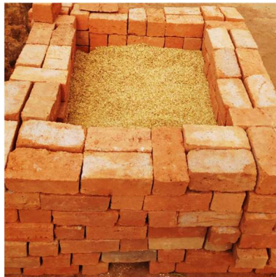
Figure Erreur ! Il n'y a pas de texte répondant à ce style dans ce document..3: Incinérateur pour le traitement thermique des balles de riz
