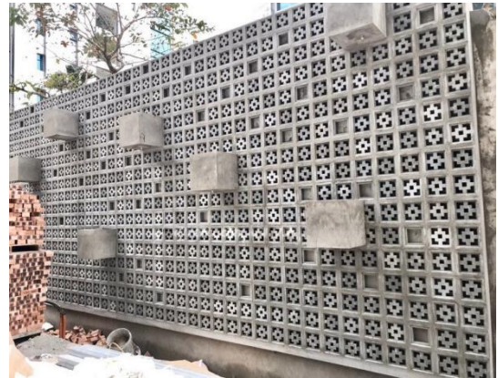
Hình 30. Sử dụng gạch thông gió làm tường rào cho công trình (Linhceramics, 2020)
