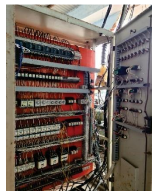
Hình 8. Tủ điều khiển
