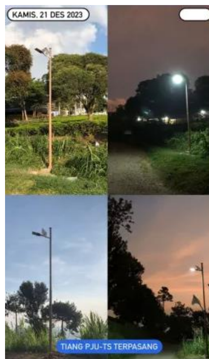
Gambar 7. Kondisi PJUTS di lokasi pemasangan siang dan malam hari
