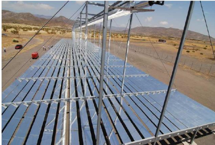
Fig. 54 Colector Fresnel FRESDEMO (Plataforma Solar de Almería)
