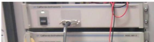
Figura B11. Módulo con los transductores.
