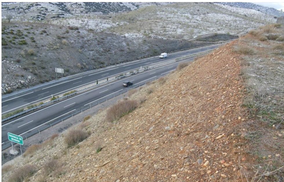
Figura 8. Desmonte de la A-92 en Fiñana (Almería).
