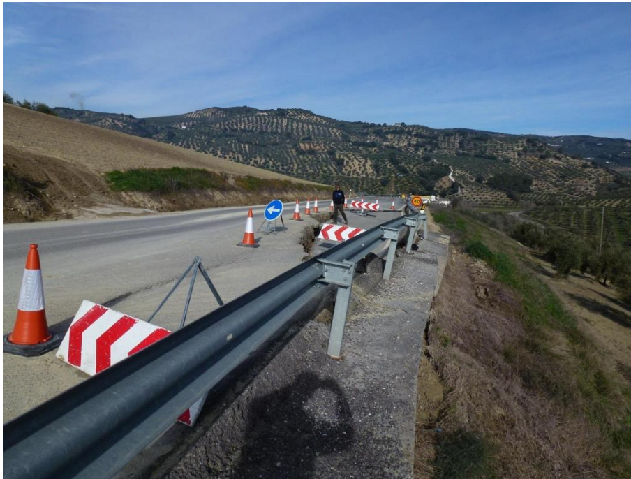
Figura 1. Deslizamiento en una carretera.
