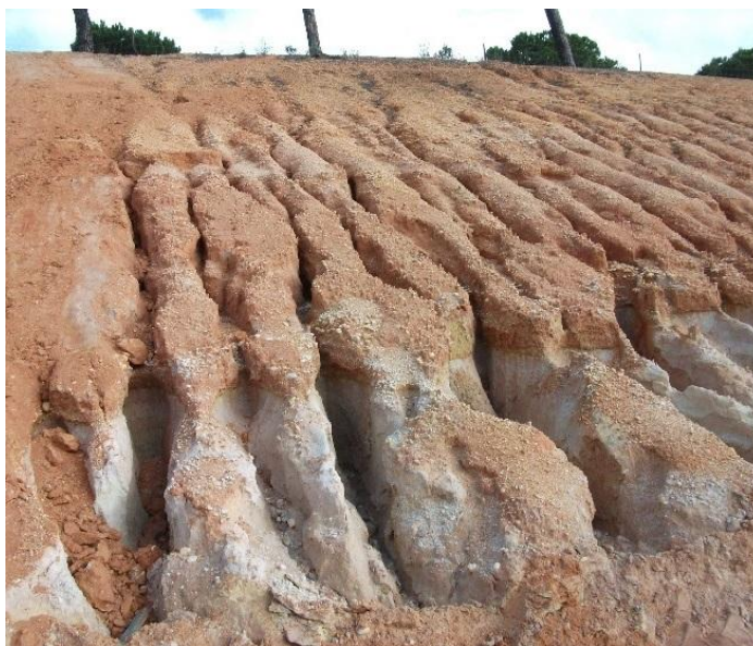
Figura 12. Detalle de cárcavas en talud A-5058, en Cartaya (Huelva)
