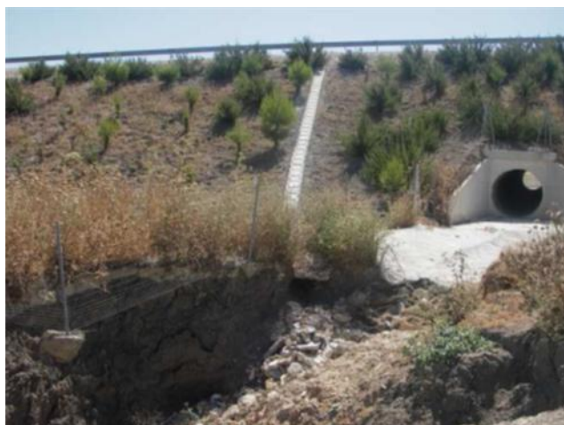
Figura 17. Cárcava producida por un desagüe mal ejecutado.
