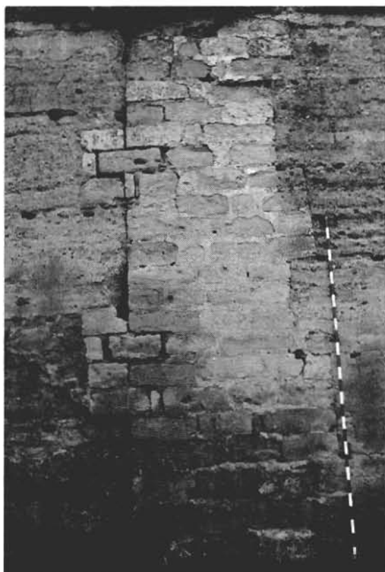
FOTO 5. Machón de sillería en la cara interna de la muralla, ubicado entre las torres 1 y 3
