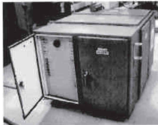
Figura 85. Banco de condensadores empleado en un equipo de conformado electromagnético
