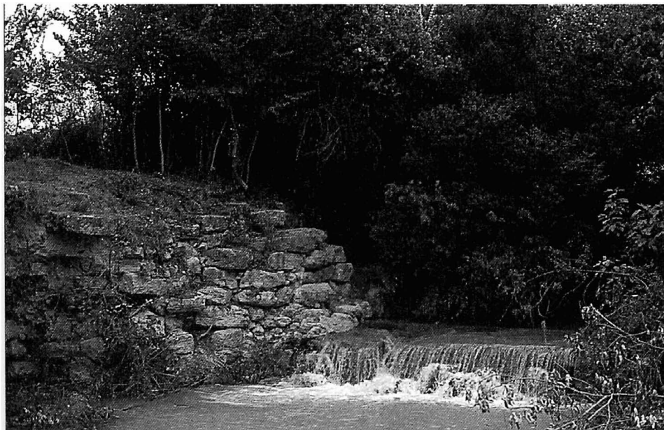
Lám. 3.- Detalle de la pantalla y rotura de la Presa Vieja de Deifontes.
