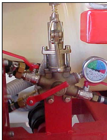
Figura 8.13.-Detalle de regulador de presión y de distribuidor.
