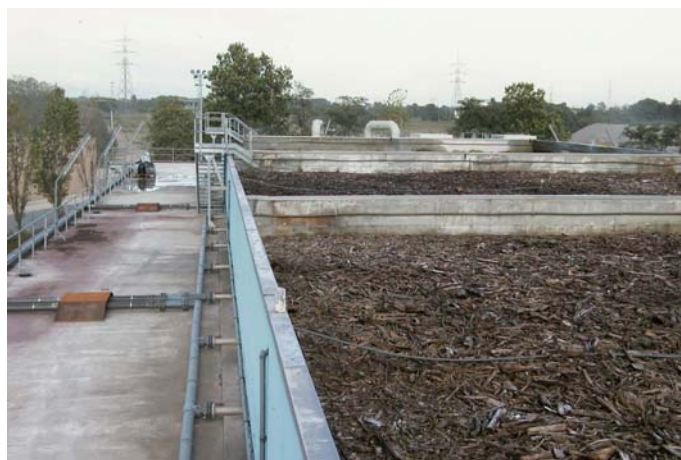
Figura 27. Aspecto de los tres biofiltros con los que cuenta la planta.
