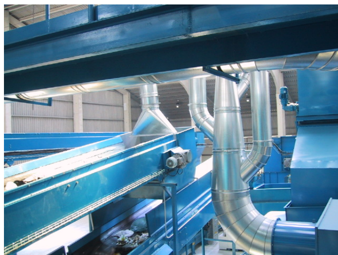
Figura 15. Aspecto de los conductos de aspiración que garantizan la calidad del aire dentro de la planta de Compostaje
