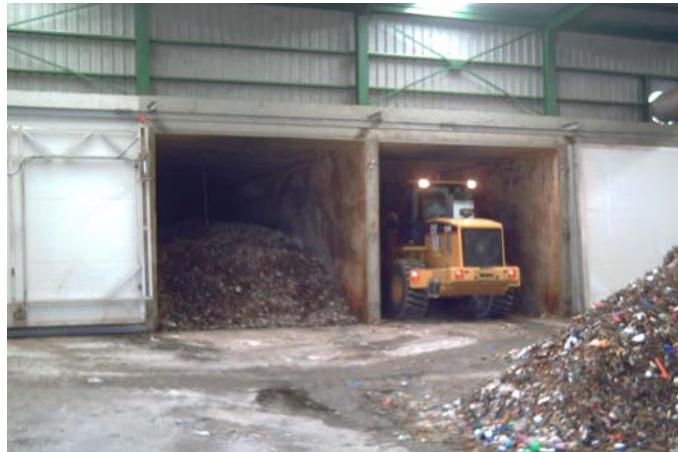
Figura 21. Túnel de Compostaje. En su interior se observa el residuo.
