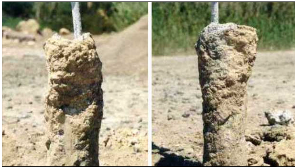
Fig. 95: Detalle de la rugosidad del fuste de los pilotes instalados en campo.
