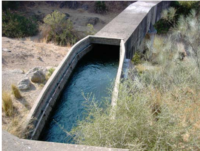
Figura 4.23. Salida del agua de la presa de derivación del Bembézar al canal
