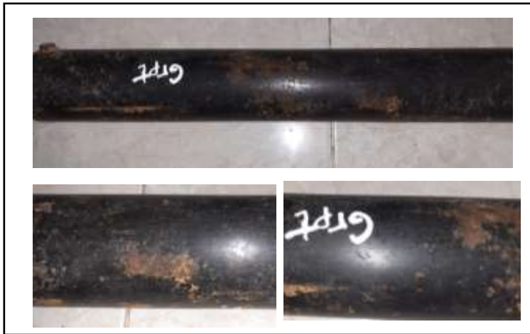
Gambar 4.13 Keadaan Pipa API 5L Setelah Mengalami Proteksi Menggunakan Graphite Backfill
