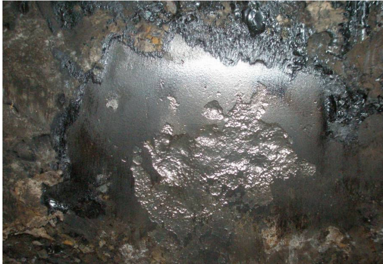
Рисунок 2. Локалізоване корозійне ураження магістрального газопроводу ЄДК
