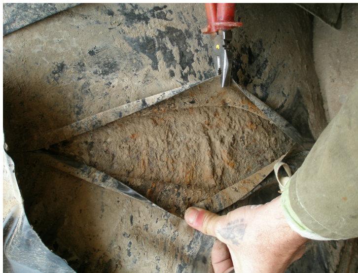
Рисунок 3. Руйнування захисного ізоляційного покриття внаслідок дифузії через нього компонентів ґрунтового електроліту
