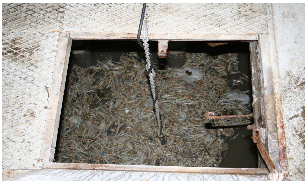
Figur 14. Placering af dykpumpe i pumpeump ved etablering af omrøring.
