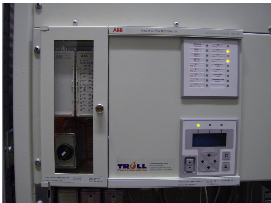
Figur 2.14: Billede af differentialrelæ ABB REL 561 monteret i transformstation A7
