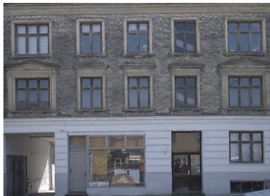
Figur 7.22: Facadebillede korrigeret 0,25 m i front og 0,75 m i begge sider. Det ses, at noget af porten er skåret væk.
