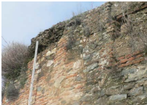
Figura 8: Detalle de restos de tapial que sobresalen sobre la rasante en el lienzo D, proximidades de la poterna, donde suponemos pudo existir una torre hoy desaparecida.
