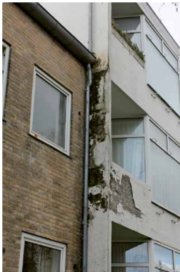
ØVERST Ibstrupparken, Gentofte. Nedbrydning af støbte karnapper på grund af korrosion i armeringsjern. Udstøbningen omkring jernet er for tynd, hvorved jernet udsættes for fugt og rust.
