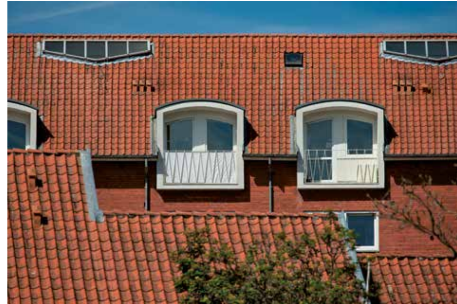
De hvidmalede altaner i beton er et meget karakteristisk kendetegn for perioden, her som effektivt element i overgangen mellem den murede facade og tegltaget.
