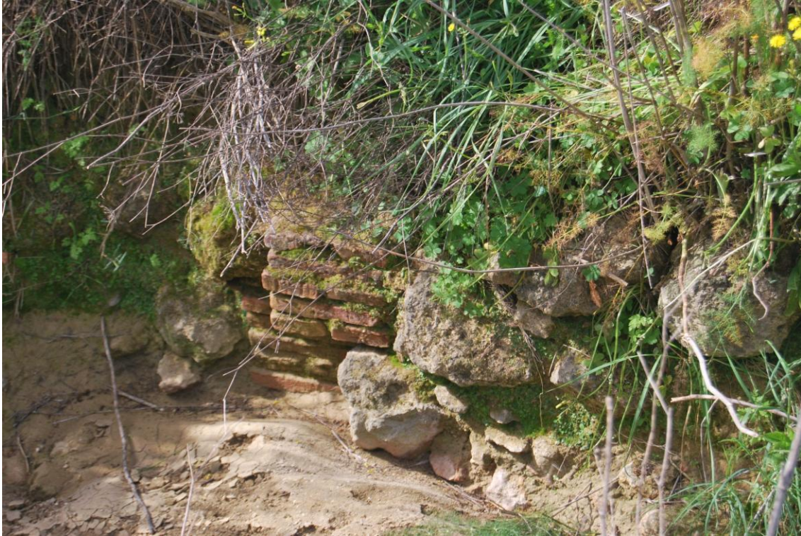
Imagen 4.4.7 Sillar de ladrillos abatido por la erosión del agua del arroyo.
