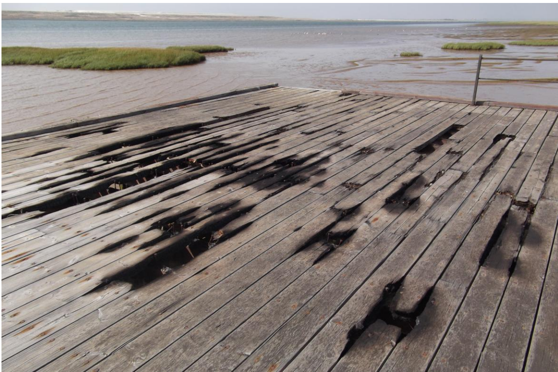
Imagen 5.1 Estado actual del muelle de la Calzadilla. Palos de la Frontera. Autor.
