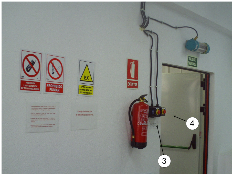
Figura F.3: Elementos del sistema de seguridad ubicados en la sala de procesado de hidrógeno II
