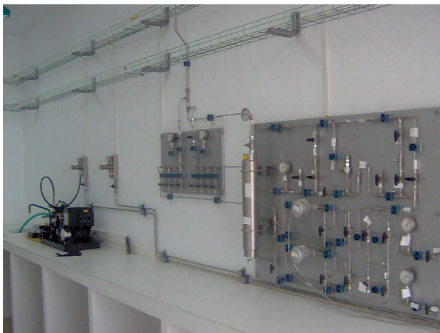
Figura 5.10: Vista de la sala de procesamiento de hidrógeno ya montada
