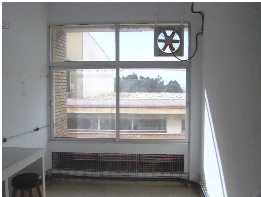
Figura 5.6: Sistema de ventilación artificial de la sala de procesado de hidrógeno
