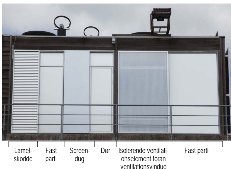
Figur 8. Foto af Energy Frames elementerne monteret på Dagslyslaboratoriet, her vist i lukkede positioner.
