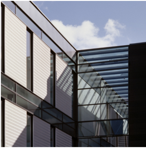
Figur 4. Motoriserede udvendige skodder, udført med stålrammer og perforerede aluminiumsplader.
