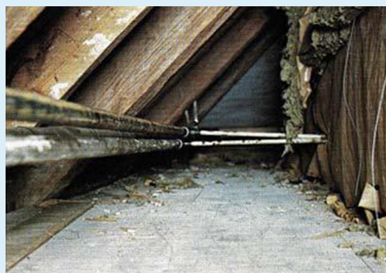
Uisolerede centralvarmerør i skunkrum.
