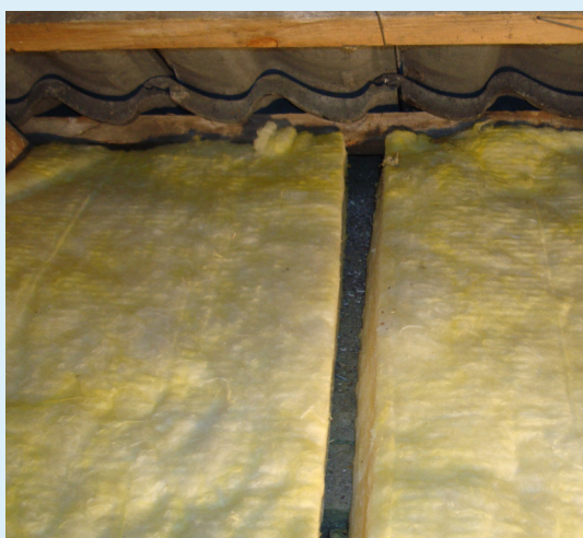
Loftisolering med sprække.
