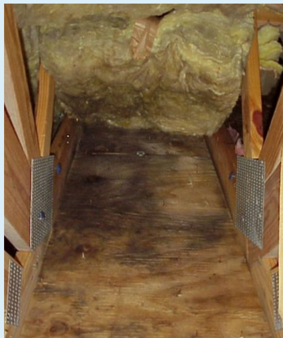
Fugtskade med angreb af skimmelsvamp.
