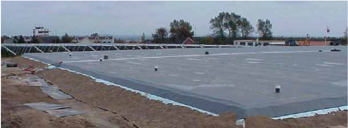
Foto: Marstal Fjernvarme
