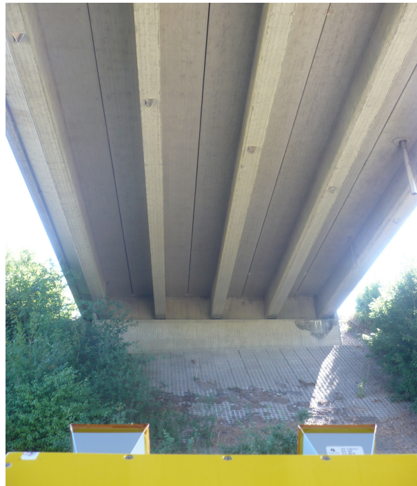
Abbildung 5.14: Aufnahme der angebrachten Reflektoren in Blickrichtung vom GBR aus. Pro Steg wurde ein Reflektor angebracht. Die Reflektoren sind von links nach rechts mit 1 bis 5 durchnummeriert (siehe Abbildung 5.15).
