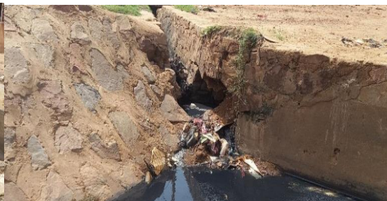
Photo 5. Point de rejet des eaux usées du centre dans la rivière
