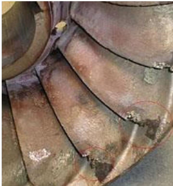
Figura IV. 2 - Erosión en las impulsoras de una bomba
