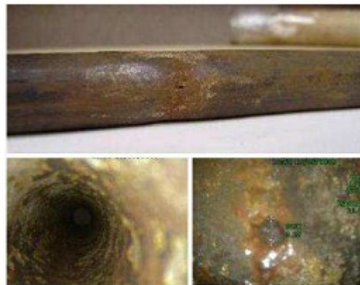
Figura 14 Corrosión por pitting
