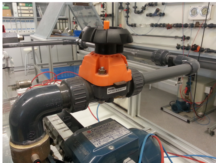
Figura 3.4: Válvula de membrana de la instalación.
