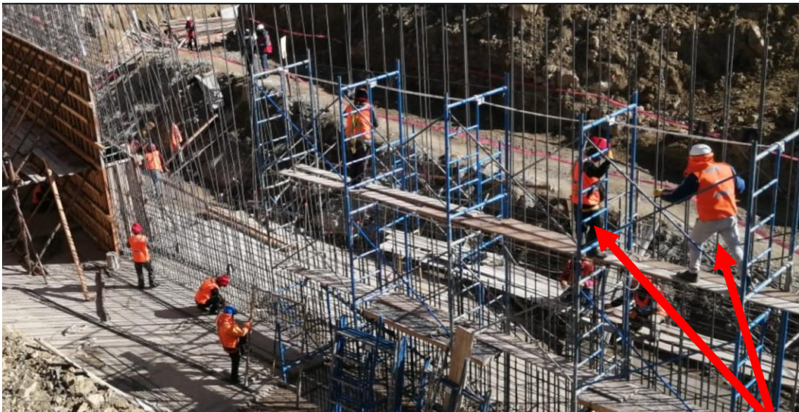
Figura N°1. Actos y condiciones subestándares en trabajos en altura
