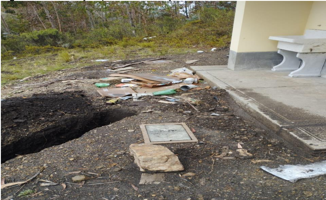
Figura N° 4. Orden y limpieza deficiente y falta de señalización
