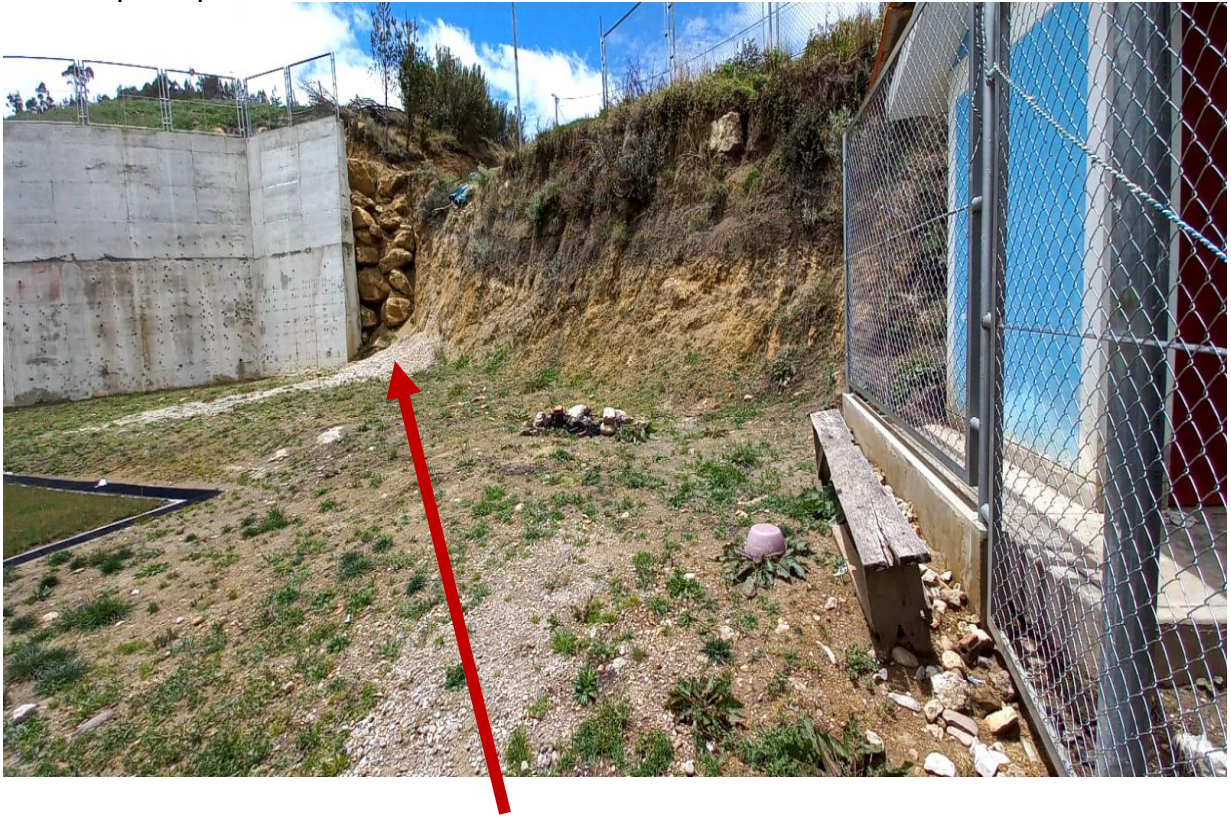
Rocas sueltas en un proyecto que fue terminado, dejando rocas sólo apiladas en un centro educativo
