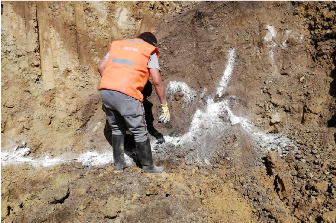
Figura N°7. Colaborador sin el EPP adecuado.
