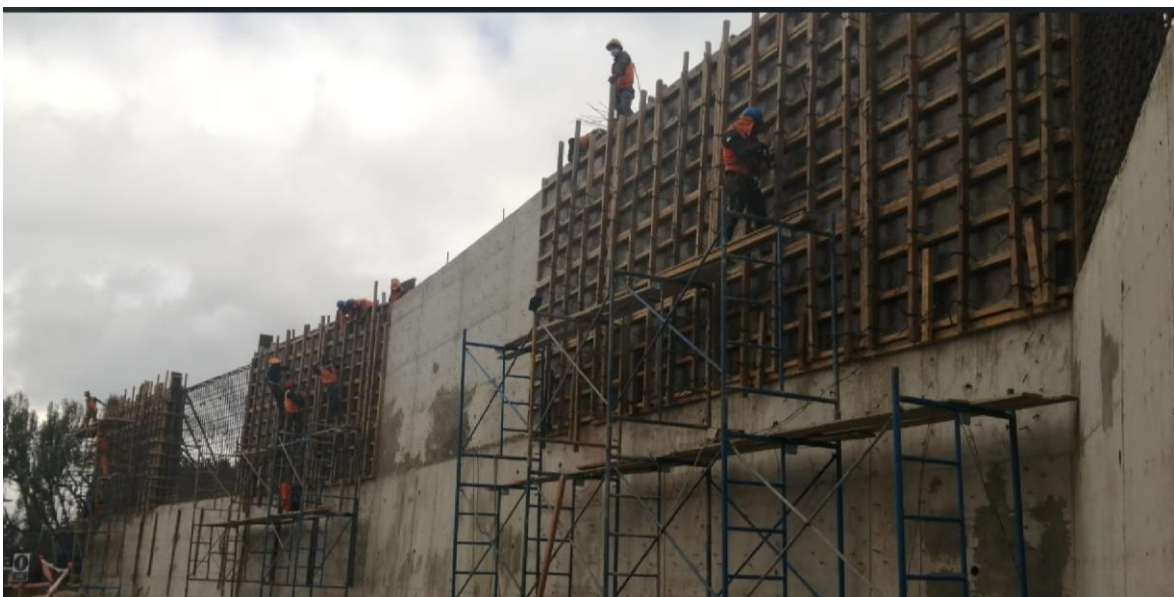
Figura N° 2. Colaboradores trabajando en trabajos de altura con andamios sin barandas de seguridad.
