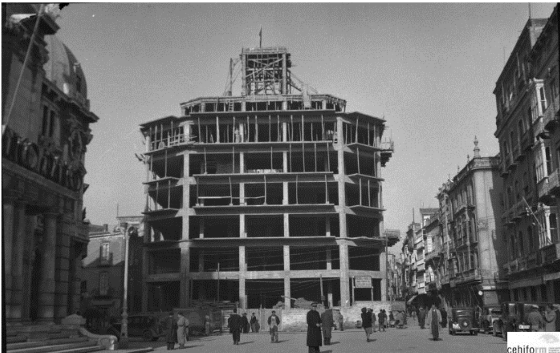
Fig. 53 Edificio Mancomunidad de los Canales de Taibilla en construcción. (Colección Archivo Casaú. Archivos Históricos de la Región de Murcia. Proyecto Carmesi)
