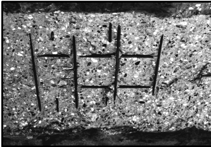
Fig. 8.6 Losa de hormigón sin fibras después del ensayo frente al fuego
