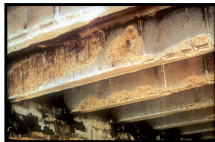
Fig. 5.3 Ejemplo de elementos de hormigón mostrando desconchados
