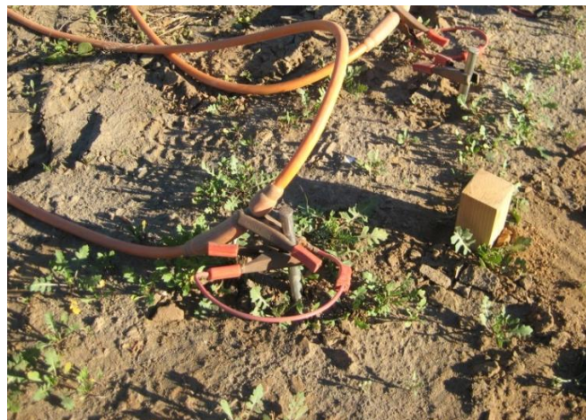
Imagen 9: detalle de la conexión entre el cable multiconductor y un electrodo
