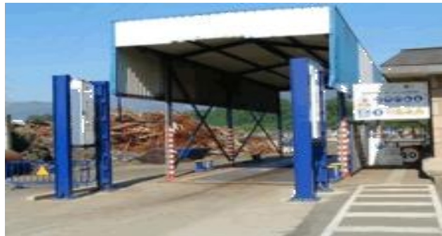
Figura 9.2.4.1. Pórtico vigilancia radioactiva y báscula
