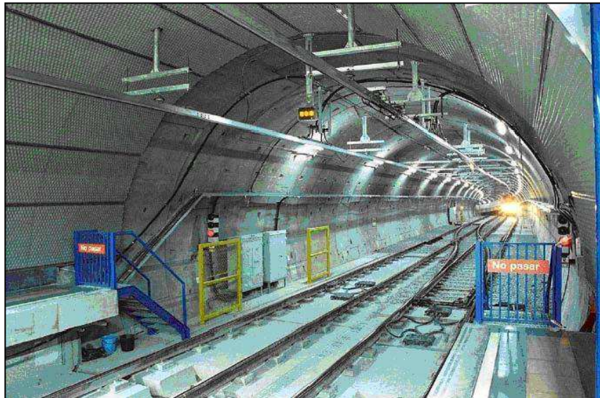
Imagen 4: Catenaria aérea rígida en Metrosur Metro de Madrid.
