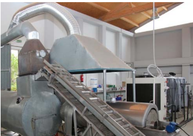
Planta de destilación del vino de la UPCT
