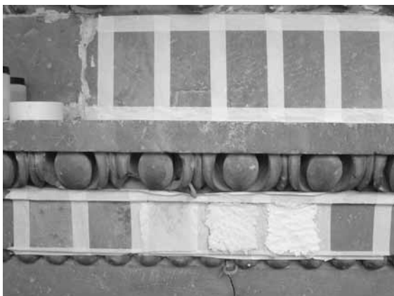
Figura 9. Pruebas de limpieza con carbonato de amonio (dos concentraciones diferentes (25% y 50%)) en la cornisa de la fachada E. Vista frontal. F. Artelan.
