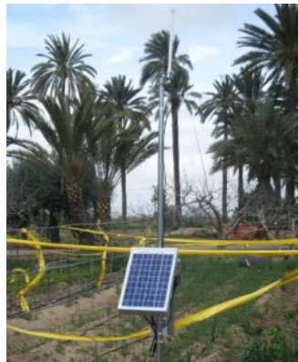
Figura 6.15. Vista del Gateway que se instaló en la parcela.
