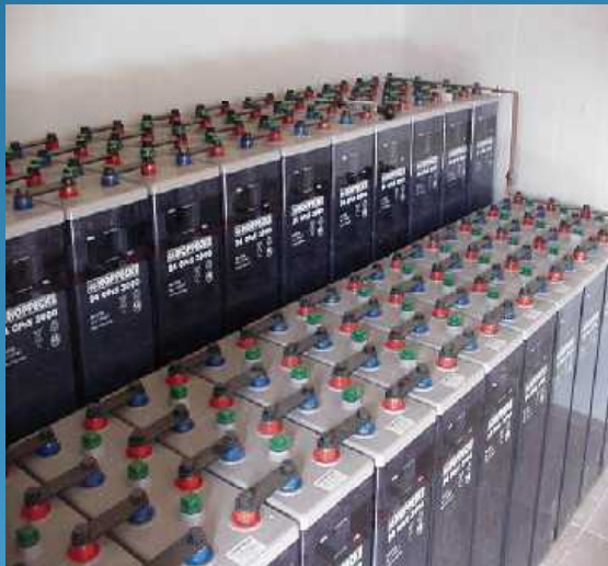
Banco de baterías industrial
