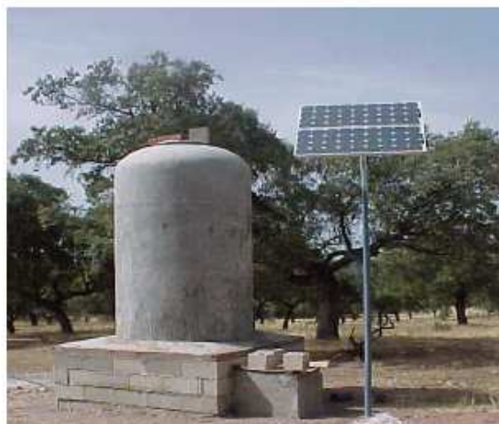
Instalación de bombeo fotovoltaico
