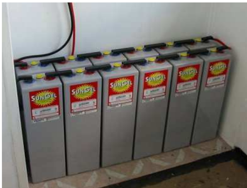
Baterías de gel usadas en las instalaciones solares fotovoltaicas
