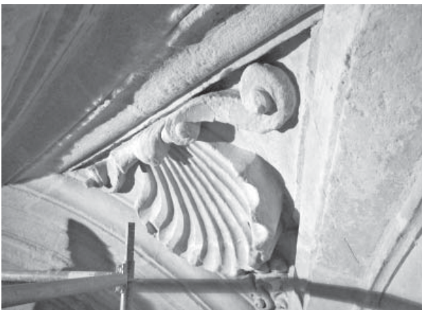
15.5. Primer plemento de la bóveda del segundo cuerpo de la torre, desde el andamio dispuesto para su limpieza en 2003.
