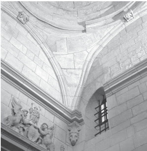
10.10. Pechina deformada en la bóveda de la antesacristía.
