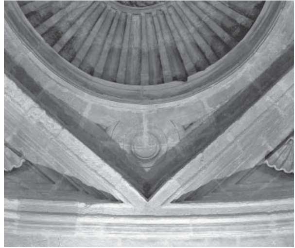
15.10. Tercer pllemento de la bóveda de la estancia del segundo cuerpo de la torre.
