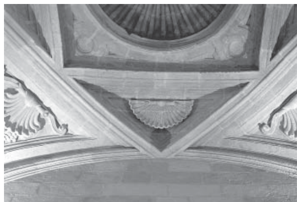
15.8. Segundo plemento de la bóveda de la estancia del segundo cuerpo de la torre.
