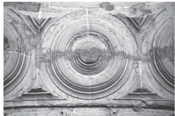
11.11. Óculos en la bóveda de la antecapilla de Junterón, desde el andamio dispuesto para su limpieza en 2003.
