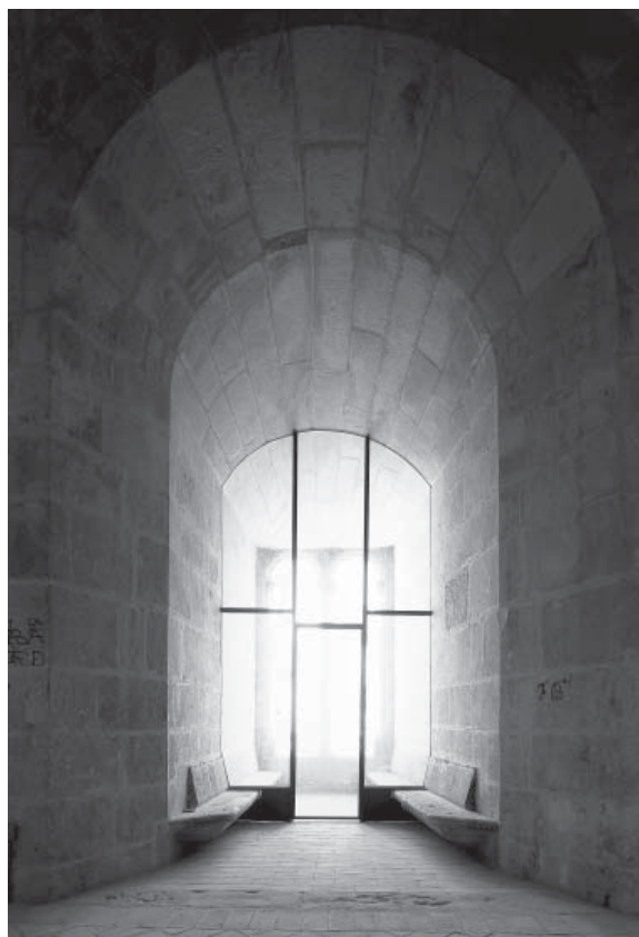
9.27. Capialzado en el trasdós de la bífora que ilumina el segundo cuerpo de la torre.
