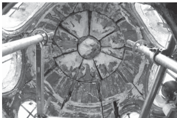
5.1. Bóveda de naranja en la linterna de la capilla funeraria de Gil Rodríguez de Junterón, desde el andamio dispuesto para su limpieza en 2003.
