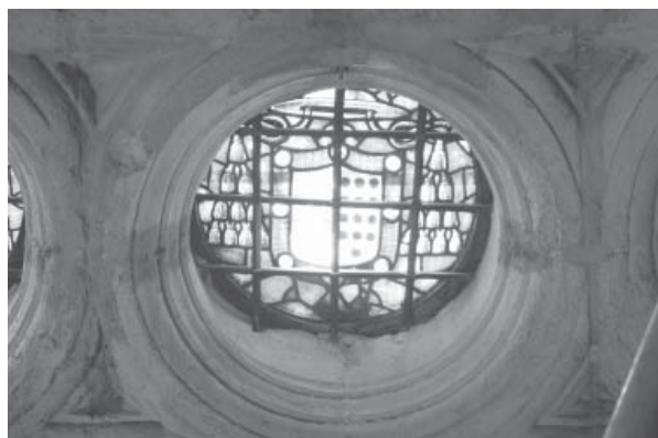
11.12. Óculos perforados en la bóveda de la antecapilla de Junterón, desde el andamio dispuesto para su limpieza en 2003.
