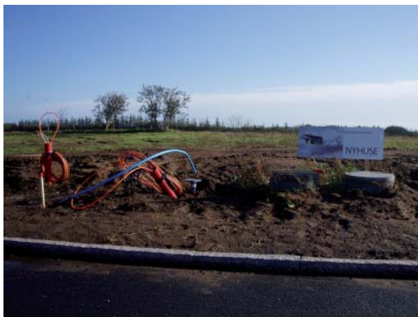
På billedet ses hele samlingen af infrastruktur til et parcelhus. Fra højre ses: spildevand, vand (stophane) og el mm.
