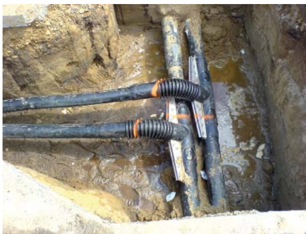
På billedet ses en stikledning og dens samling med hovedledningen i vejen. Stikledningen er til et parcelhus.
