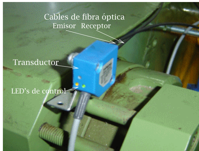
Figura 3.2: Transductor fotoeléctrico instalado en la máquina FIAP.
