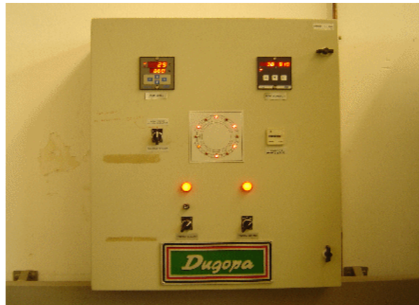
Figura 2.18: Armario de control del horno de fusión y mantenimiento.
