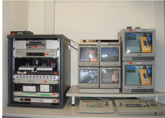
AV control area
