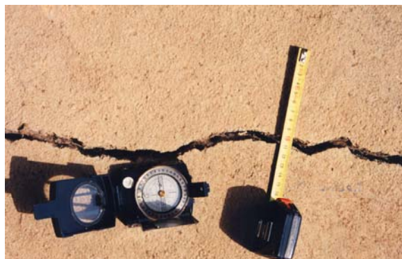
Foto 8.9. Grieta nº 35, decimétrica, en el porche interior de la nave de “Sondeos Cabezos”.
