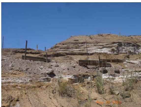
Foto 5.7. Colocación de tablones entre los troncos para evitar derrames de lodo. Balsa de la mina Santa Antonieta.
