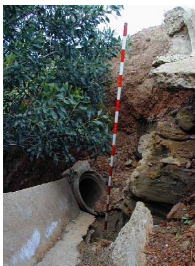
Foto 9.17. Rotura de la red de drenaje.
