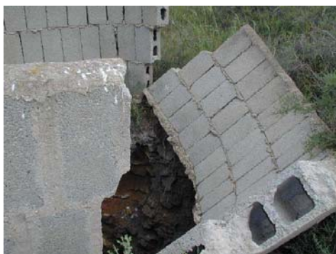
Foto 9.7. Rotura del brocal en el pozo 117-C167 por hundimiento del terreno.
