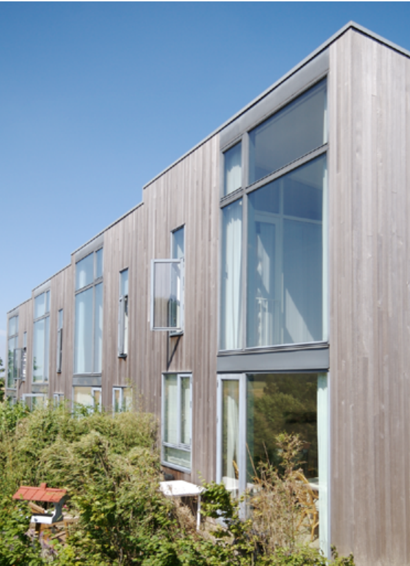
Passiv solvarme har skabt veldokumenterede problemer med overophedning om sommeren. Solsikkehaven, Vonsild, 1995.
