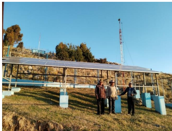
Energía fotovoltaica (Paneles solares)
