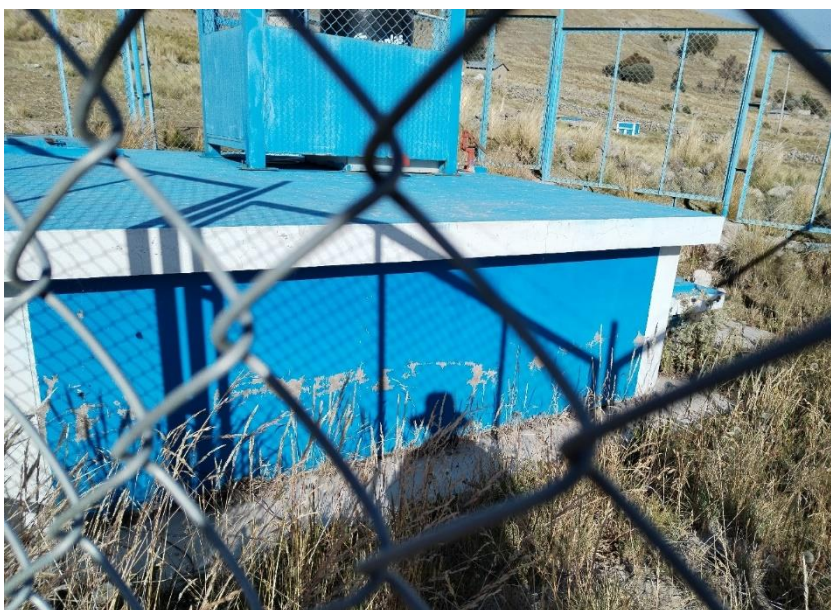
Figura 21. Reservorio de sistema de agua de Villa Santiago
