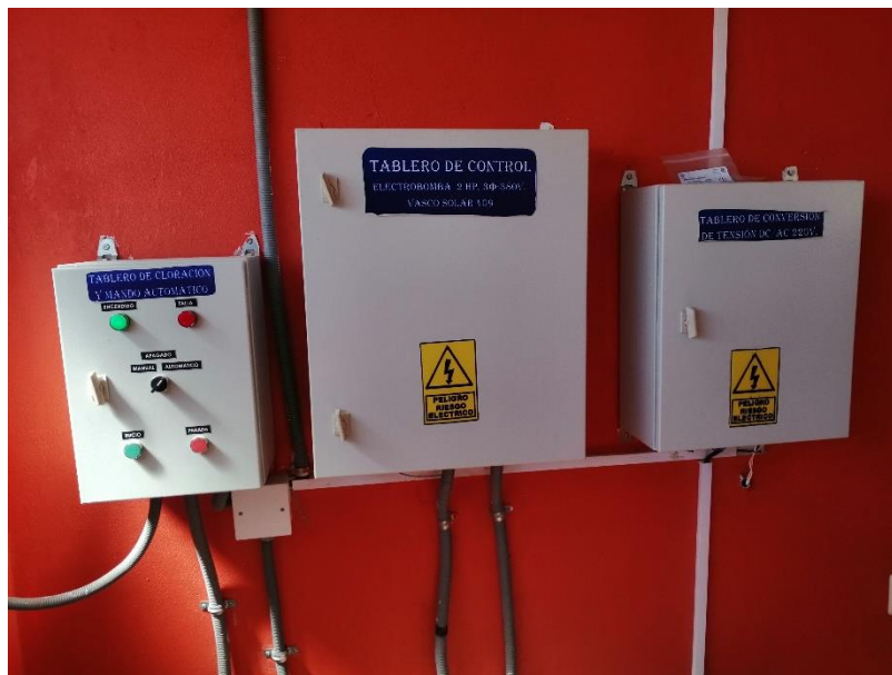
Figura 22. Operatividad de los equipos de electrobomba de sistema de agua de Sajsani
