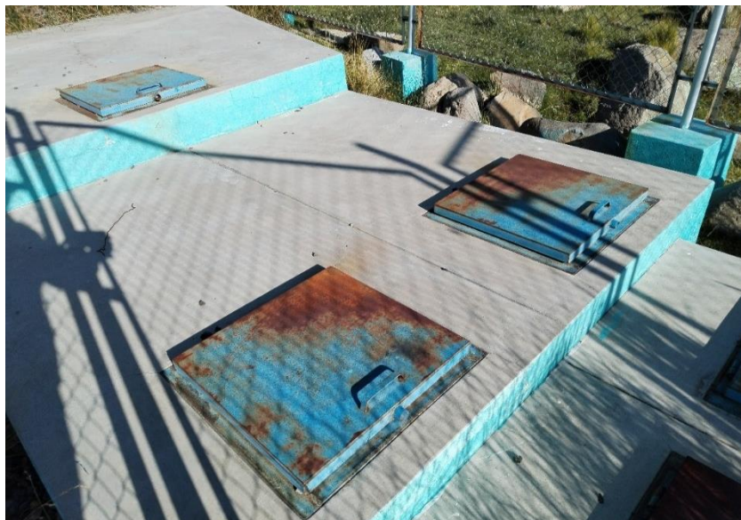
Figura 19. Tapas de captación de sistema de agua de Chatuma
