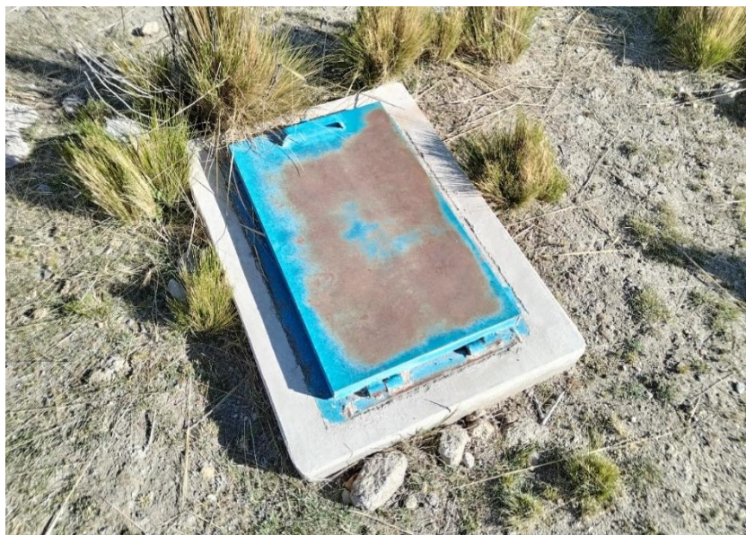
Figura 20. Cajas de válvula de control
