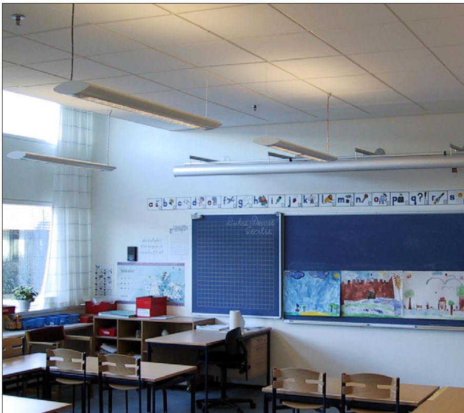
Figur 79. Forsøgslokale 1.11 mod syd. Lokalet har 9 stk. opad-/nedadlysende armaturer, der er opdelt i 3 grupper, som styres via en fælles føler monteret ud for de højtiddende dagslysvinduer.
