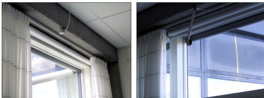
Figur 80. Dagslysføler i forsøgsrum. Ved afleveringen af belysningsanlægget (t.v.) var føleren placeret for højt og modtog ikke tilstrækkeligt dagslys til at reguleringen kunne fungere. Senere blev dette ændret, så føleren placeredes på holder foran det øverste vindue(t.h.).
