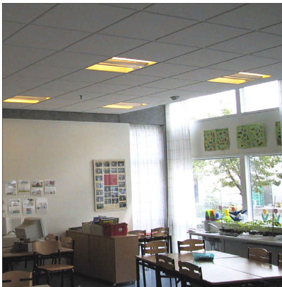
Figur 81. Referencelokale 1.13 mod syd. Belysningen er indirekte, nedadlysende armaturer indbygget i loftet. Reguleringen af lyset sker via bevægelsesmelder og en lysføler monteret på loftet.
