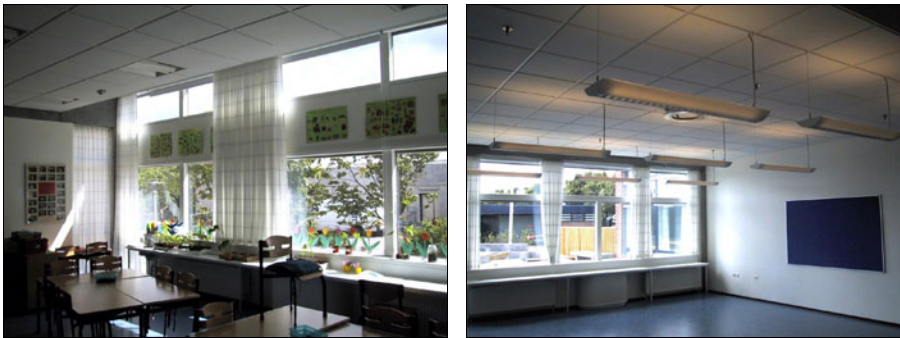
Figur 15. Hedegaardsskolen. I lokalene mod vest (højre billede), har man valgt ikke at lade det nedhængte loft gå helt op til betondækket, og derfor optræder det faste parti ikke på denne facade.
