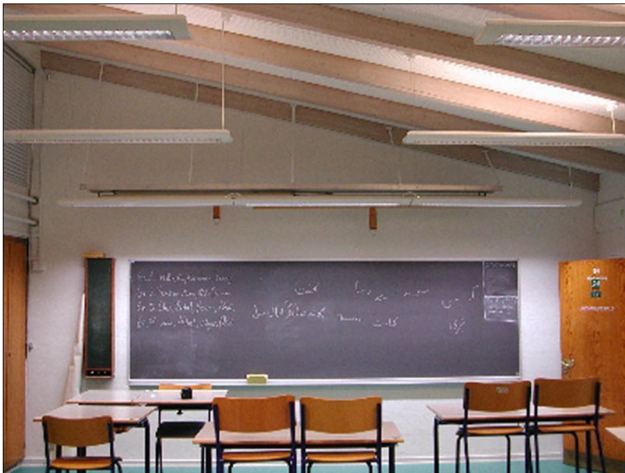
Figur 71. Den nye tavlebelysning består af 3 asymmetrisk lysende armaturer, der er sat sammen til et effektivt lysbånd.
