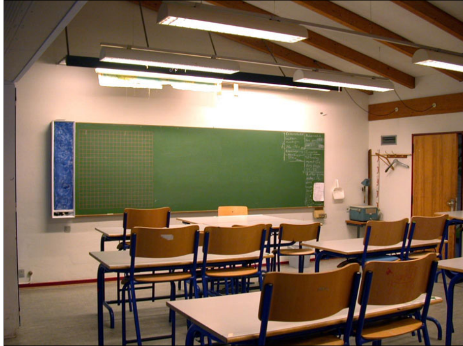
Figur 69. Den gamle tavlebelysning bestod af en lyskasse med 3 uindfattede lysstofrør.
