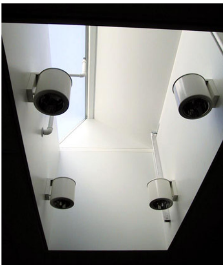
Figur 19. Ovenlys på Hedegaardsskolen. Selv på de nye skoler ses det ofte, at belysningsarmaturer placeres i ovenlysene, hvilket kan reducere dagslysendtaget betydeligt.
