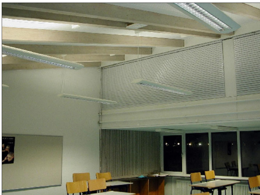
Figur 67. Den nye almenbelysningsanlæg består af ialt 9 armaturer med nye energieffektive, dæmpbare lysstofrør.
