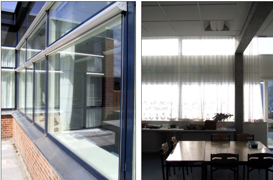
Figur 42. Hedegaardsskolen, nye del. De udvendige rullegardiner, der er indbygget i facaden, er delt i en del, som dækker det øverste dagslysvindue, og en del, som dækker udsigtsvinduet. Indvendigt er der suppleret med hvide gardiner, som kan få en generende høj luminans ved direkte solbestråling.
